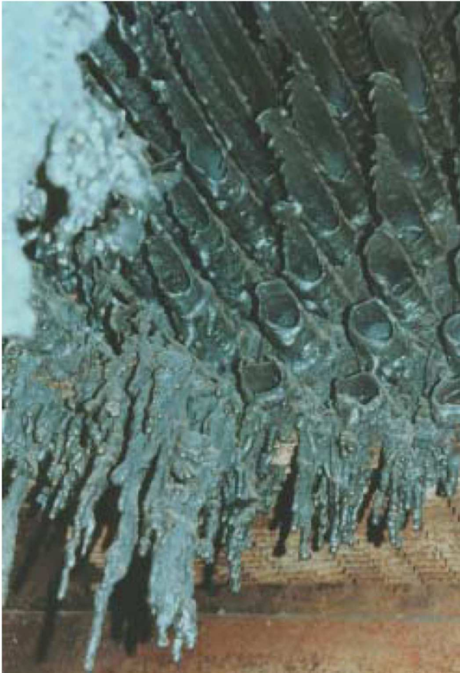
Posljedice požara na vodocjevnom GP na isp. plinove
